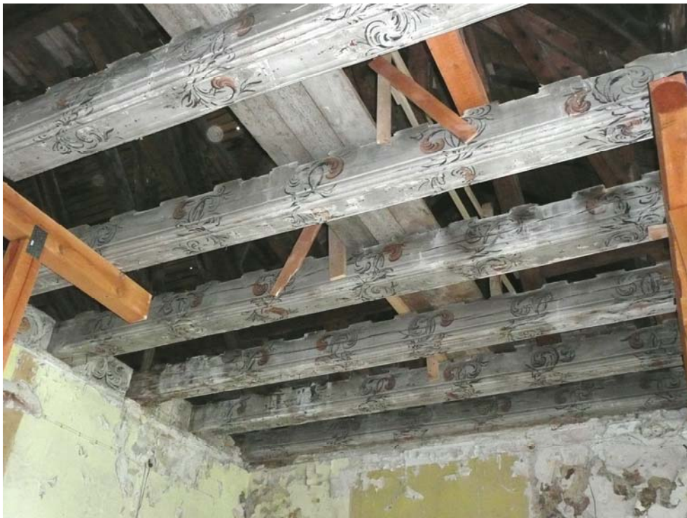
Bild 5 Historische Holzbalkendecke. Die ursprüngliche Balkenbemalung ist noch erhalten. Jedoch liegen bereichsweise erhebliche Feuchteschäden vor
