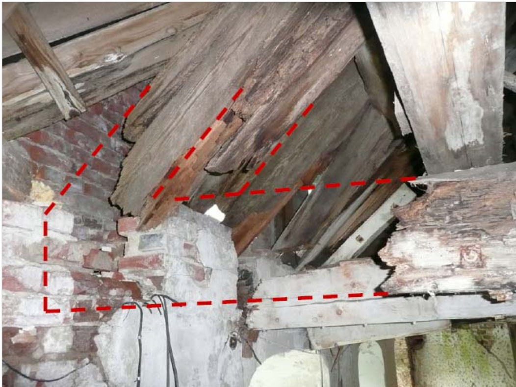
Bild 6 Schwere Feuchteschäden: Zerstörter Balkenkopf der Dachbalkenlage und geschädigter Gesimsbereich der Mauerkrone. Rot: Ursprüngliches Bauteil
