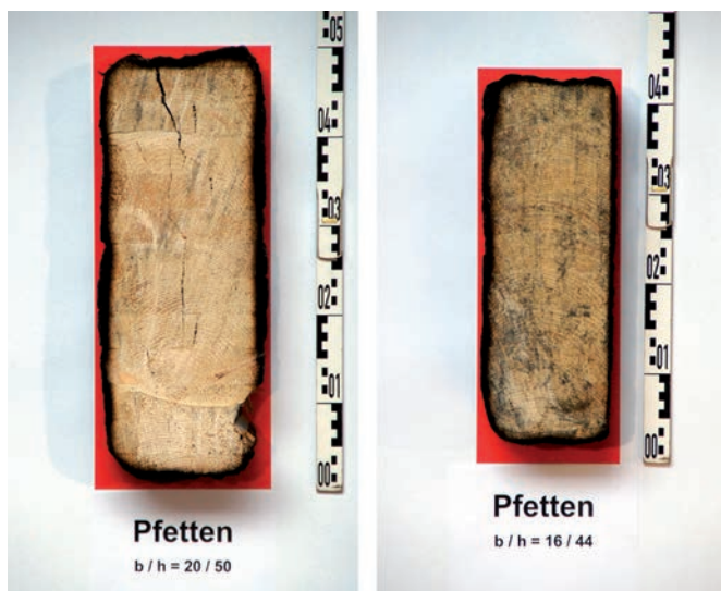
Bild 10 Hauptpfette ( b/h = 20/50 ) und Randpfette ( b/h = 16/44 ) mit Darstellung des ursprünglichen Querschnitts (rot), Restquerschnitte im Mittel: Hauptpfette b/h = 16/45 und Randpfette b/h = 13/38,5 Main purlin (width/height = 0/50) and edge purlin (width/height 16/44) showing the original cross-section (red). Residual cross-sections medium: main purlin (width/height = 16/45) and edge (width/height = 13/38,5)
